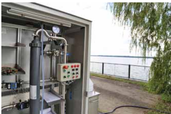
Abb. 2: Pilotanlage zur kontinuierlichen Crossflow-Ultrafiltration im Berliner Wasserwerk Friedrichshagen. Foto: Daniel Karthe
